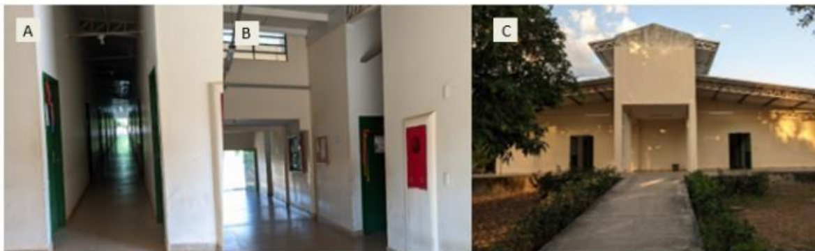
Figura 7. Entrada para corredores das salas dos professores no bloco 102. Fonte: Os autores (2024).
