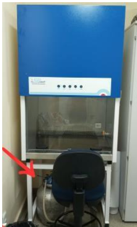
Figura 22. Bloco 105, Botijão de gás instalado dentro de laboratório do bloco 105. Fonte: Os autores, 2024.
