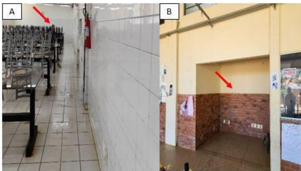
Figura 34. (A) Indicação de locais para saídas de emergência do Restaurante Universitário no interior; (B) Indicação de locais para saídas de emergência do Restaurante Universitário no exterior. Fonte: Os autores, 2024.
