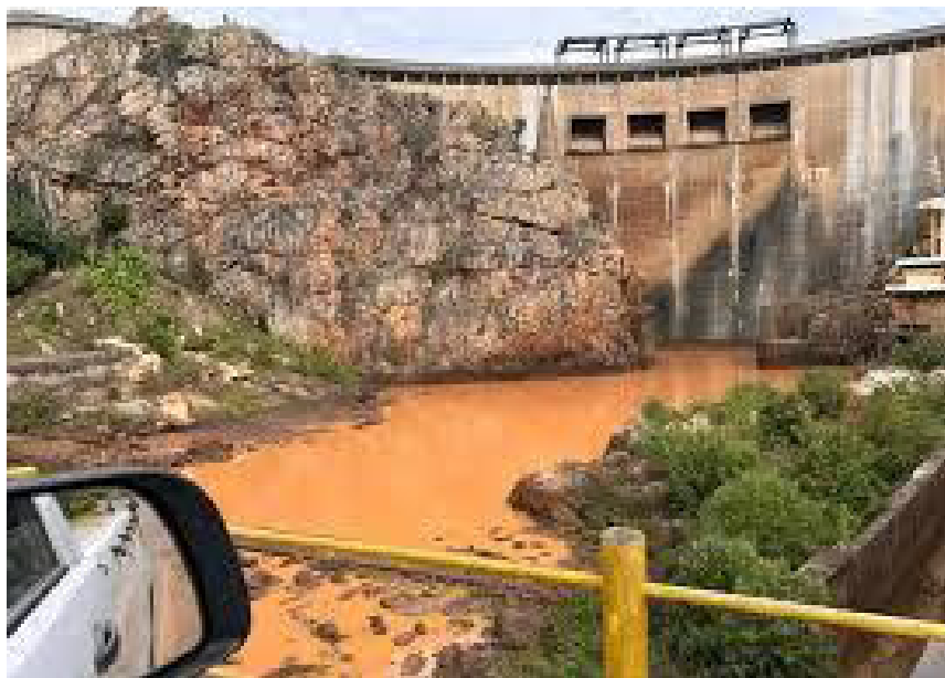
Figuras 5 e 6. Imagem da barragem de Chicamba real antes e depois da intensificação da mineração
