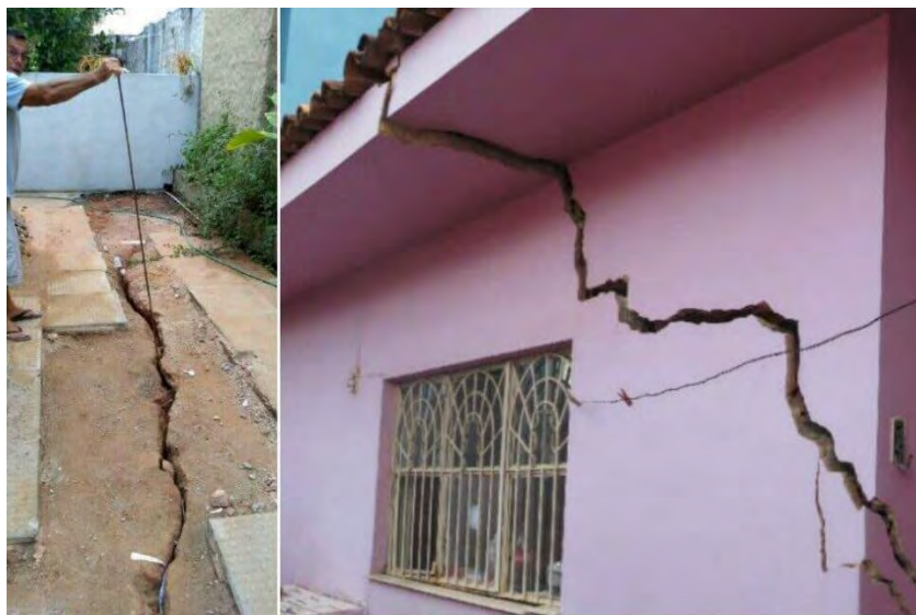
Figura 2: Fotos das rachaduras das casas e buracos das ruas de Maceió/AL
