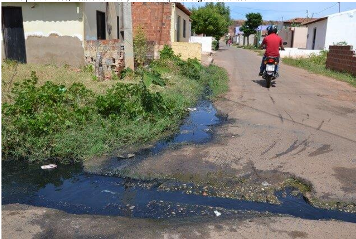
Figura 2 – Imagem da Rua Francisco Matias dos Santos, localizada no Bairro Parque de Exposição, município de Picos, Estado do Piauí, com destaque ao esgoto a céu aberto.
